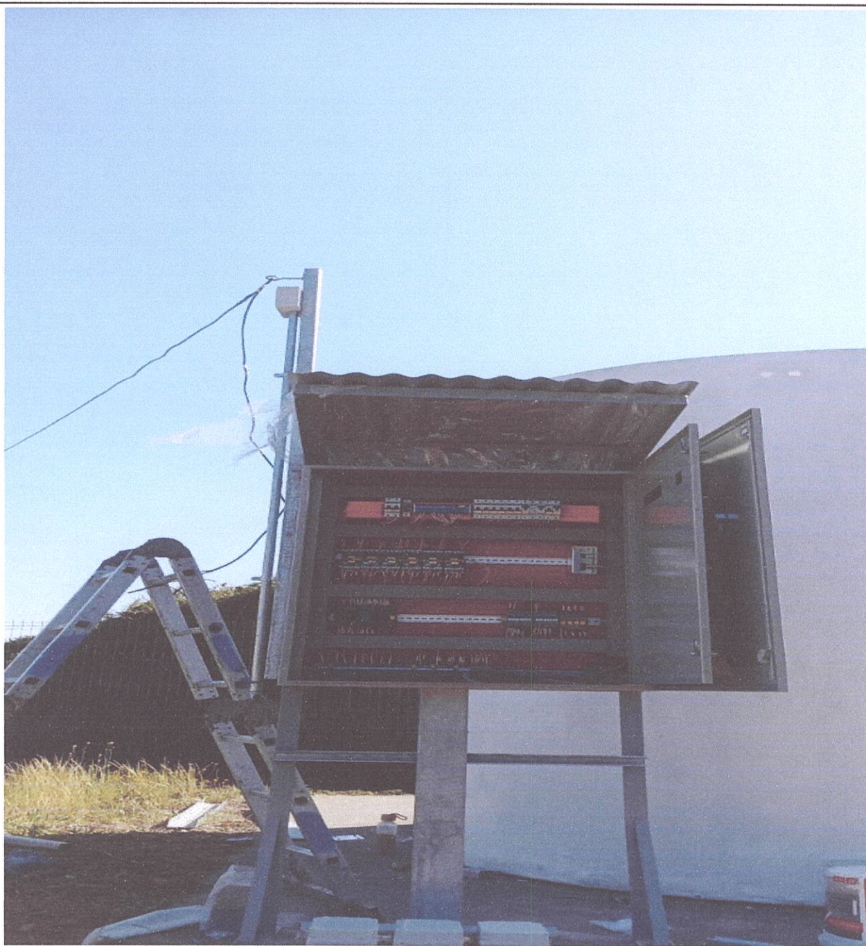
Ilustración 6: “ Tablero de Fuerza y PLC PTAS Paso del Soldado”
