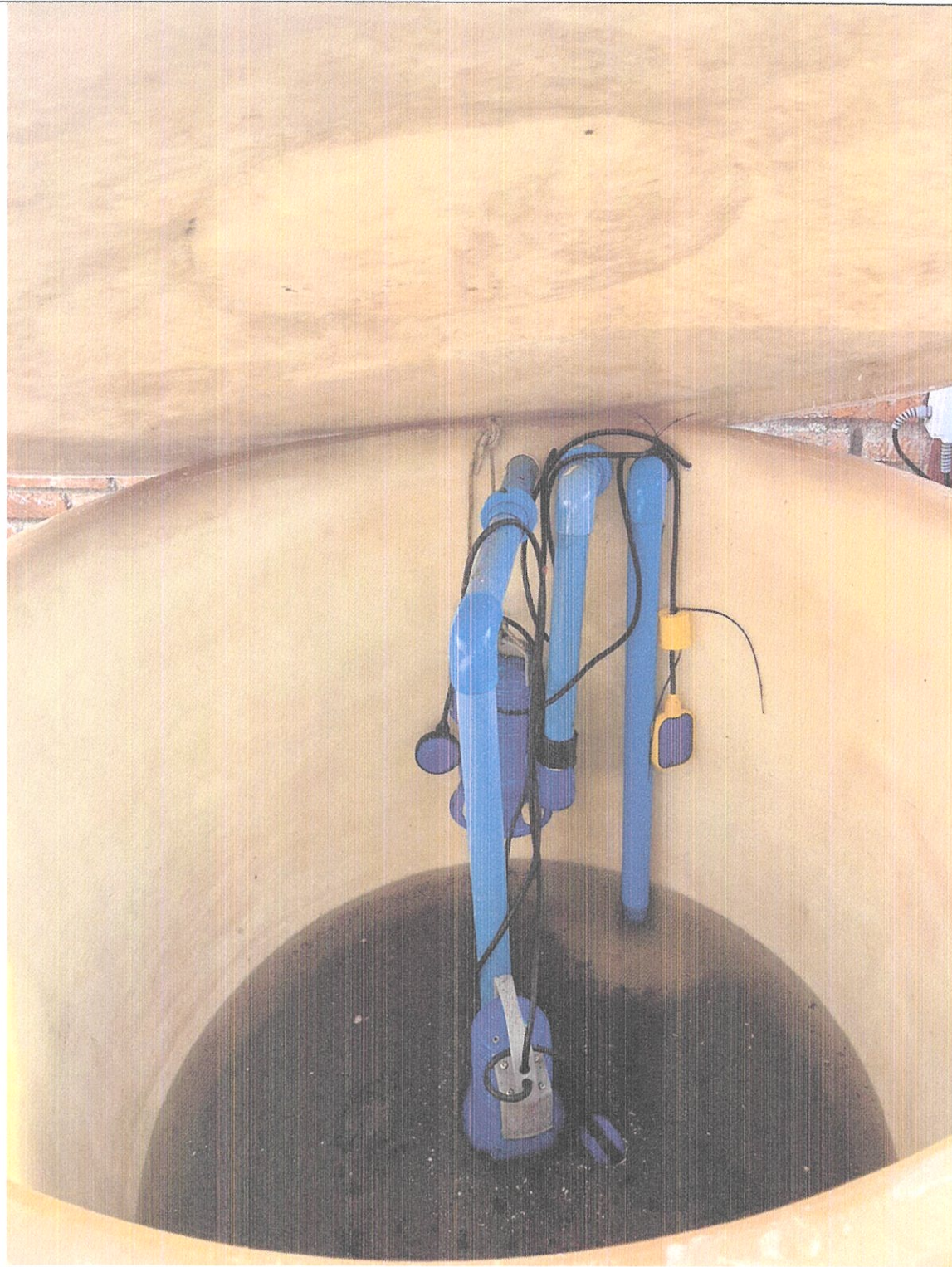
Ilustración 11: "Acumulador de lodos PTASEscuela Quelentaro"
