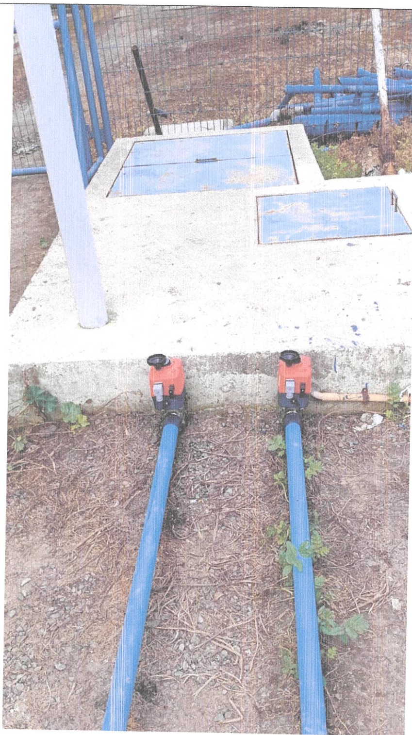
Ilustración 5: "Válvulas electroactuadas Escuela Quelentaro"
