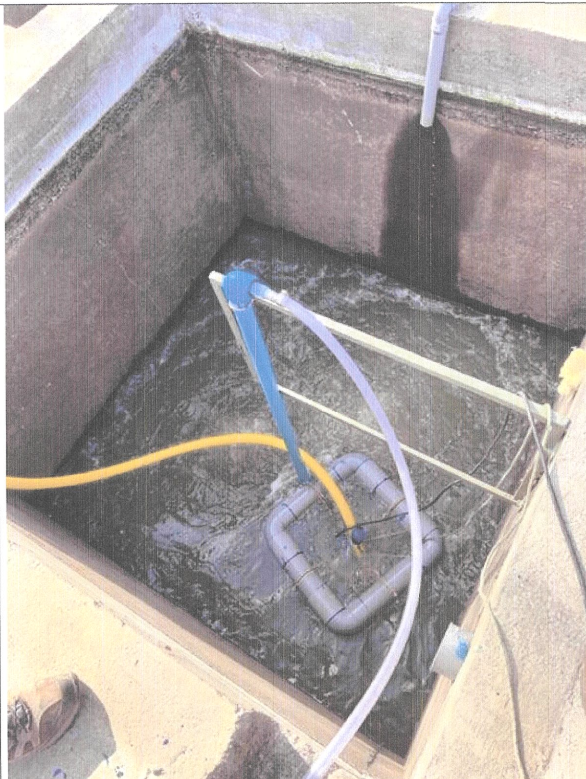
Ilustración 13: "Difusores de burbuja gruesa funcionando en digester Escuela Quelentaro"
