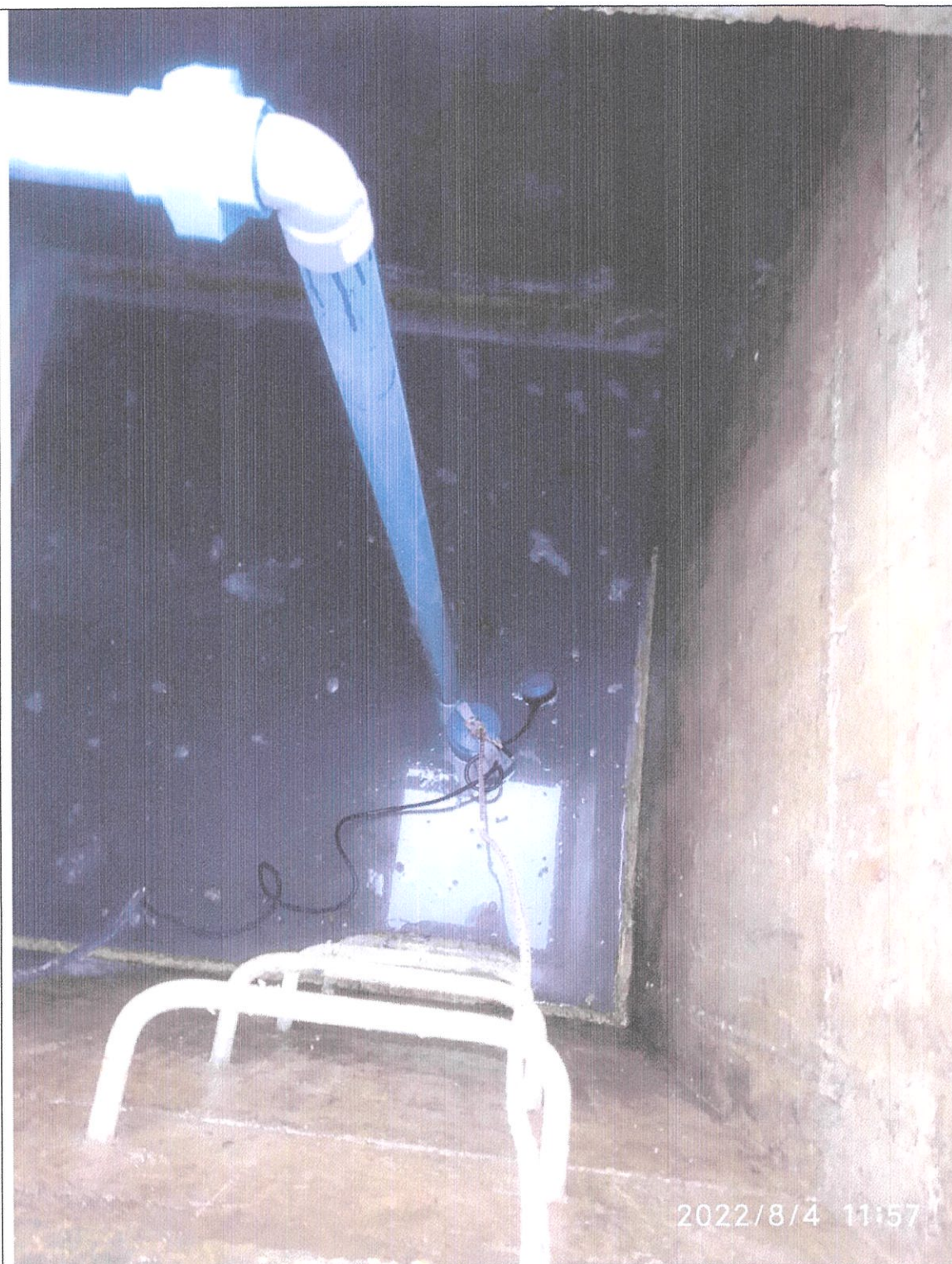
Ilustración 11: "Bomba descarga tratamiento primario Escuela Quelentaro"
