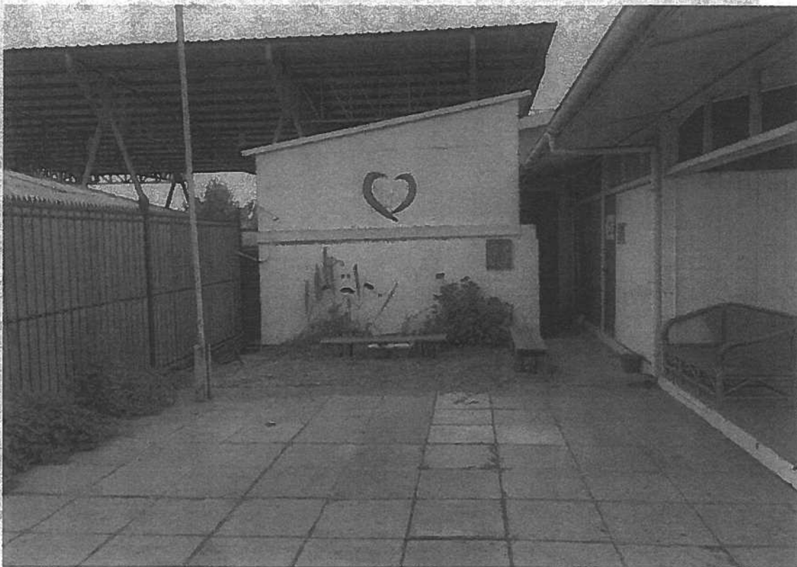
Situación Actual Mejoramiento Acceso, Centro de Salud y Departamentos de Servicios Municipal
