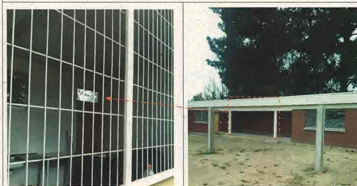
Fotografías N° 3 y 4- 10/4/2018: Construcción ejecutada en razón del Permiso de Edificación N°31, de 2016, en uso, sin encontrarse recepcionada por la Dirección de Obras Municipal de la comuna de Litueche.
