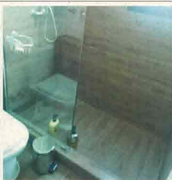
Fotografía N° 13 – 12/4/2018: Construcción ejecutada en razón del Permiso de Edificación N°41, de 2017, revestimiento de muro de calidad superior a la especificada.
