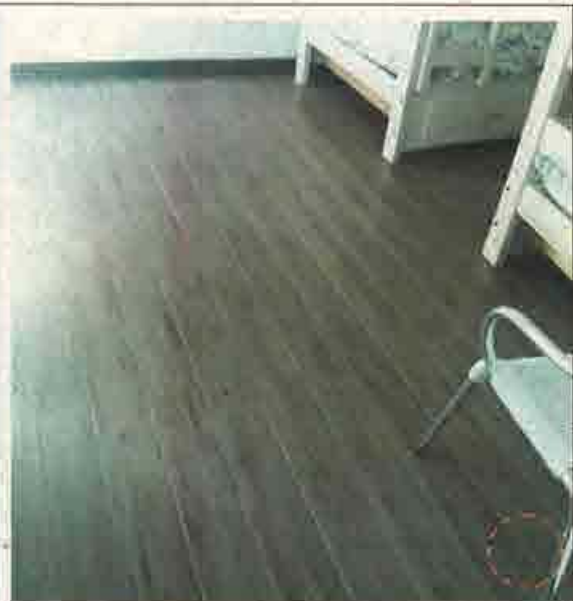
Fotografía N° 14 – 12/4/2018: Construcción ejecutada en razón del Permiso de Edificación N°41, de 2017, revestimiento de piso de calidad superior a la especificada.
